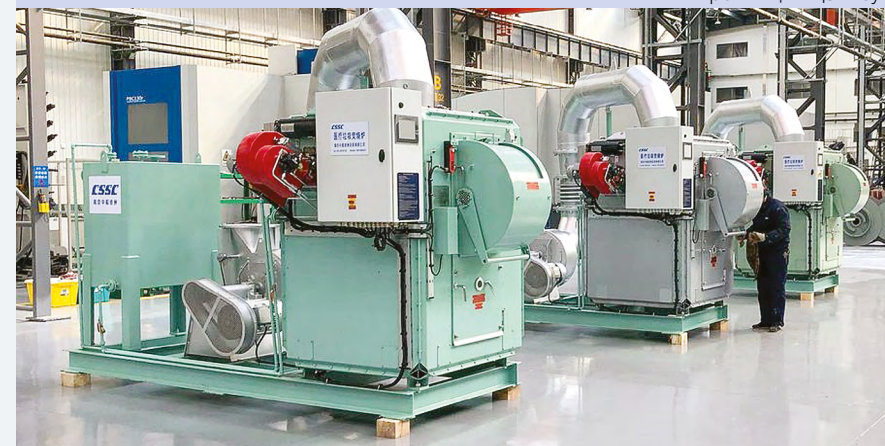
Кабины для сжигания медицинских отходов на заводе Nanjing Luzhou Machine Co., Ltd. при Китайской государственной судостроительной корпорации (CSSC) в Нанкине, провинция Цзянсу
